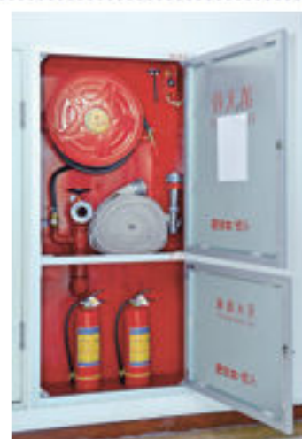
图7-8 建筑物内的消防设施
