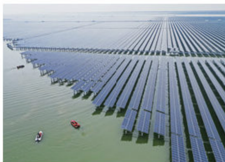
浙江温州滩涂光伏发电项目
