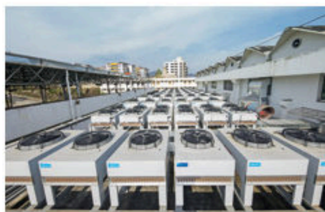
图18.4-7 大数据基地的散热设备
