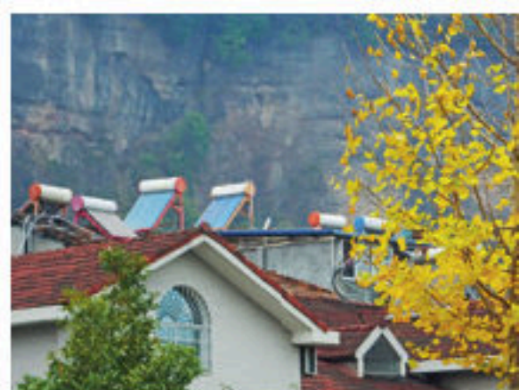
图22.2-8 屋顶的太阳能集热器
