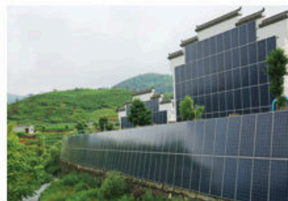
图22.3-1 农村住宅加装的太阳能电池板
